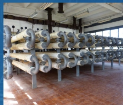
Zespół wymienników ciepła podgrzewających osad w celu fermentacji i uzyskania biogazu. Fot. J. Gawryłek
