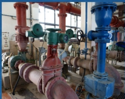
Poważnego unowocześnienia wymagają też rozwiązania technologiczne oraz sterowanie procesami oczyszczania ścieków. Fot. J. Gawryłek
