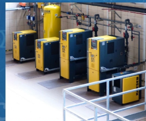
SUW Królewiec - układ sterowania procesem filtracji wody. Fot. J. Gawryłek
