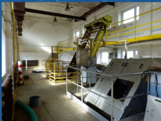
Wnętrze obiektu komory krat mechanicznych w elbląskiej oczyszczalni ścieków. Fot. J. Gawryłek
