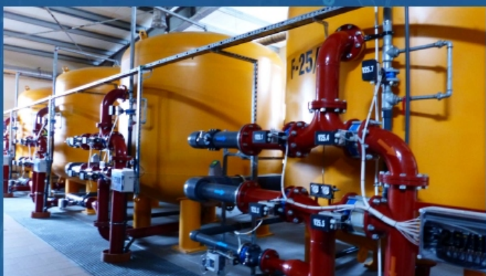
SUW Królewiec - zbiorniki filtracyjne. Fot. J. Gawryłek
