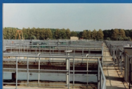
Instalacje biologicznej części oczyszczalni ścieków. AZ
