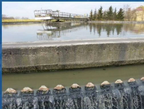
Urządzenia oczyszczalni ścieków wymagają poważnej modernizacji i częściowej wymiany. Zdjęcie z 2018 roku. Fot. J. Gawryłek
